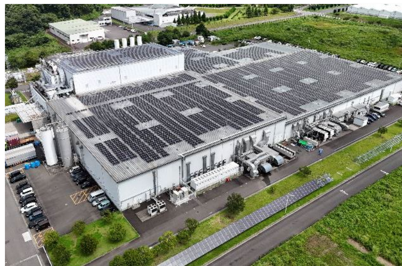
泉崎工場の太陽光発電設備
