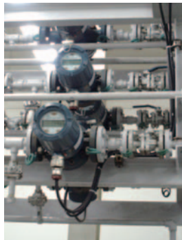
流量計の点検と監視強化
