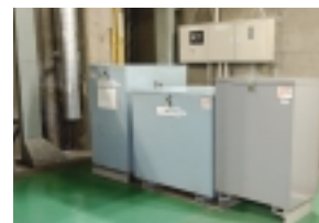
PCB保管場所 商印事業部榎町工場
