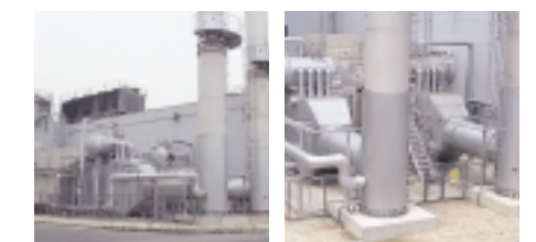
大日本印刷プレジジョンデバイス(株)三原工場コージェネレーションシステム
