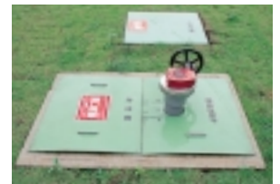
ザ・インテック(株)東京工場 緊急遮断弁
