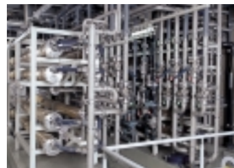
上福岡工場 超純水装置
