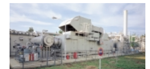
市谷事業部久喜工場コージェネレーションシステム
