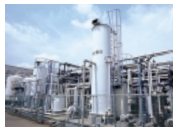
上福岡工場 純水装置
