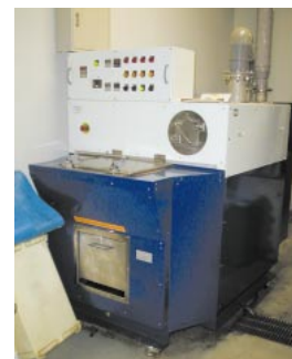
生ゴミ処理機(本社C&IビルB1)
