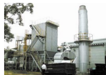
大日本印刷テクノバック 泉崎工場 焼却炉
